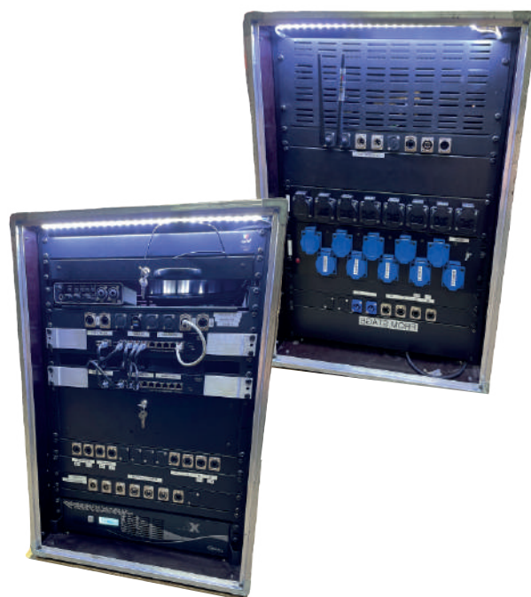
RACK STAGE 2 switch SG310 / Alim 63A vers 2 x 32A Splitter AES / onduleur
